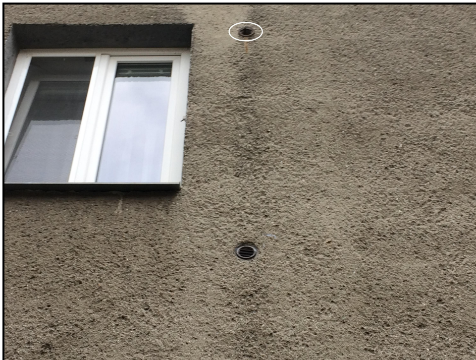
Obr. 1: Příklad ventilačního otvoru od interiéru bytu bez mřížky (elipsa) na východní straně č. p. 881 – potenciální hnízdiště ptáků
