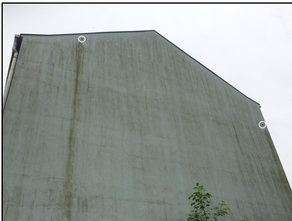
Obr. 2: Dvě díry v zateplení (elipsy) na štítové straně č. p. 883 – díra vlevo byla obsazena nejprve špačkem obecným a poté rorýsem obecným
