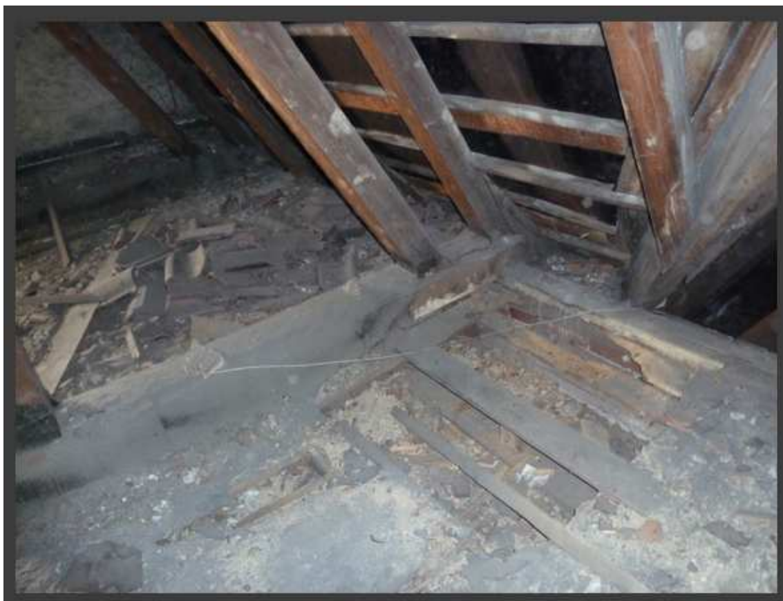
Provedeny sondy do konstrukce stropu v místě původního zatékání, ze kterých jsou zřetelné hnilobou napadené prvky podhledu a záhlaví stropního trámu.
