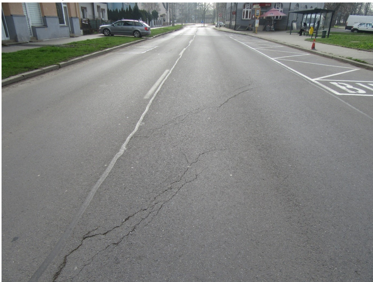
km 1,060+ Šikmé rozvětvené trhliny.
