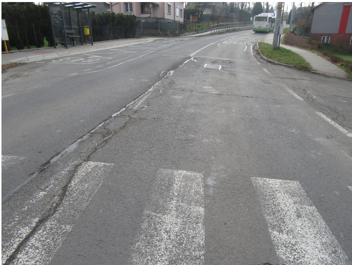
km 1,510+ Mozaikové, příčné, podélné a nepravidelné rozvětvené trhliny, vysprávký.
