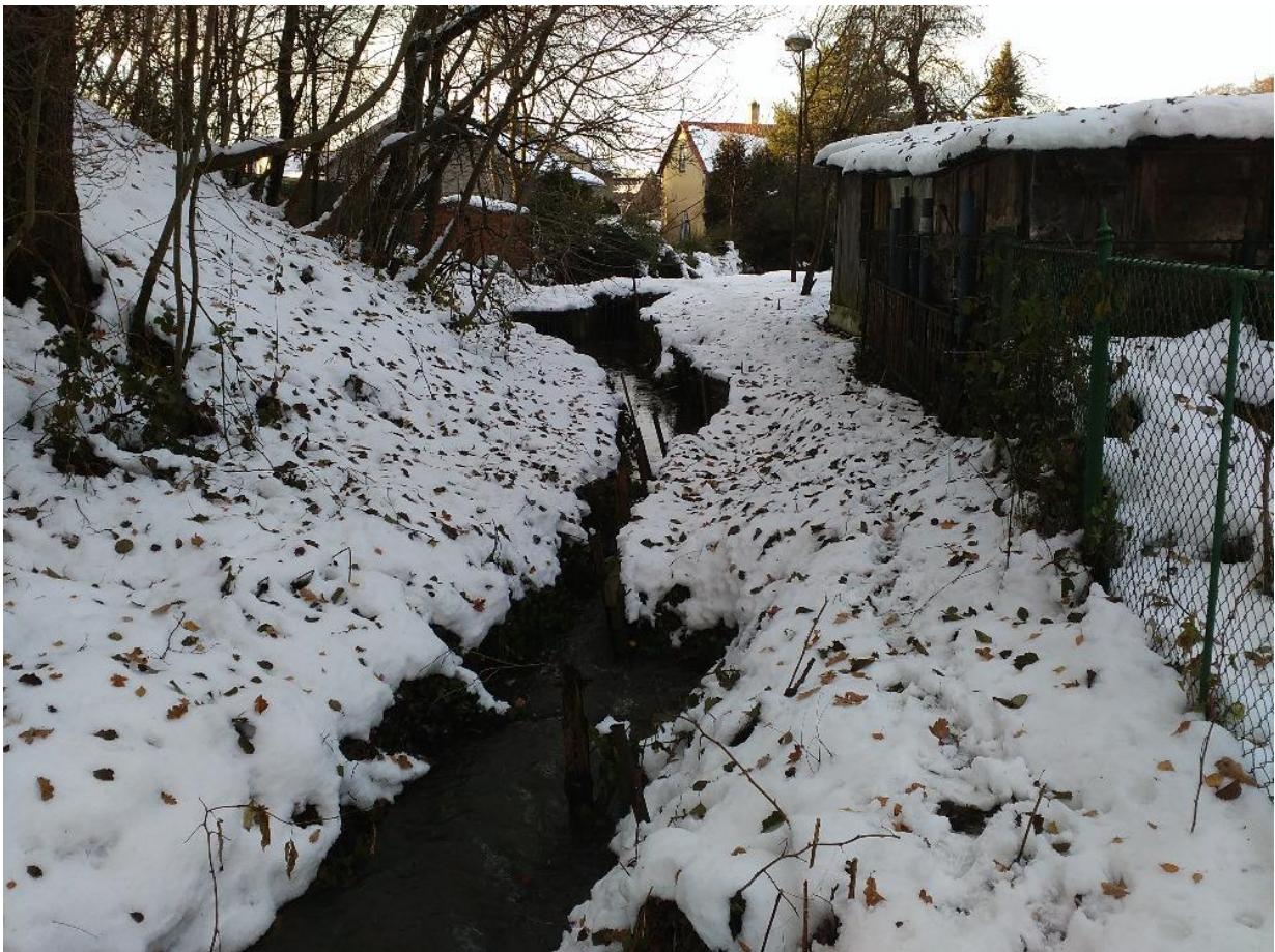
Obr. č. 1 Pohled na DVT Skřečonský potok řkm 1,942 - 1,967 – zborčené opevnění.
