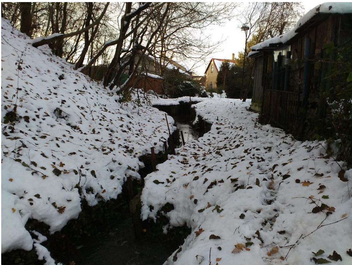
Obr. č. 2 Pohled na DVT Skřečonský potok řkm 1,942 - 1,967 – zborcené opevnění.
