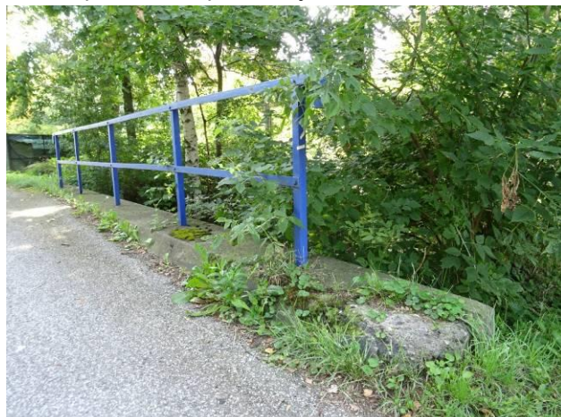
Pravá římsa a zábradlí. Na straně opěře 2 je římsa cca v úrovni vozovky. Zábradlí je krátké.
