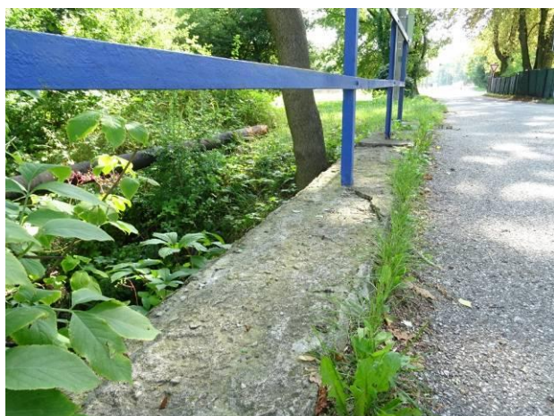
Levá římsa – detail. Odpadlá mazanina, odhalený beton zvětrává.
