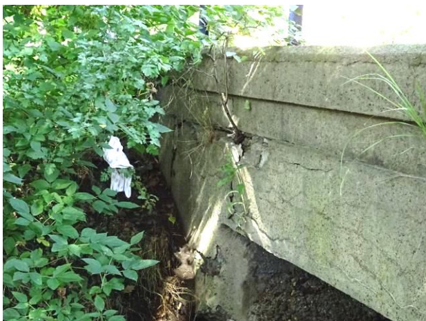
Pravý bok nosné konstrukce. Trhlina v nosné konstrukci nad opěrou 1.
