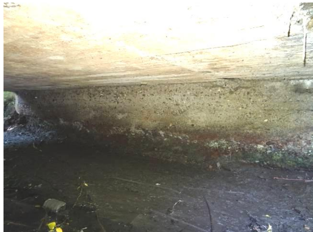
Opěra 1 zleva (od výtoku). Degradovaný beton.
