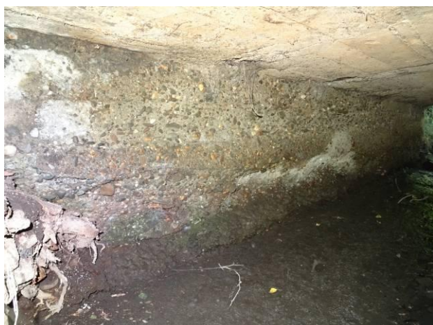
Opěra 2 zleva (od výtoku). Degradovaný beton. Vymletá spodní část opěry.
