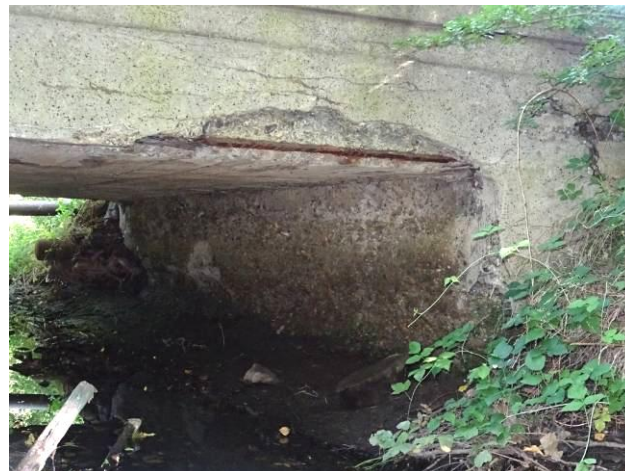
Pravý bok nosné konstrukce (vtok). Odlomená hrana nosné konstrukce – detail.
