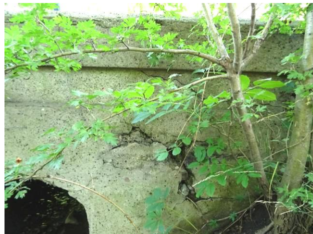
Pravý bok nosné konstrukce. Trhlina v nosné konstrukci nad opěrou 2.
