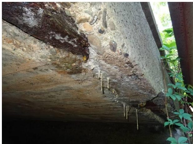
Levý bok nosné konstrukce (výtok) - pohled k opěře 1. Rozpad okraje nosné konstrukce.
