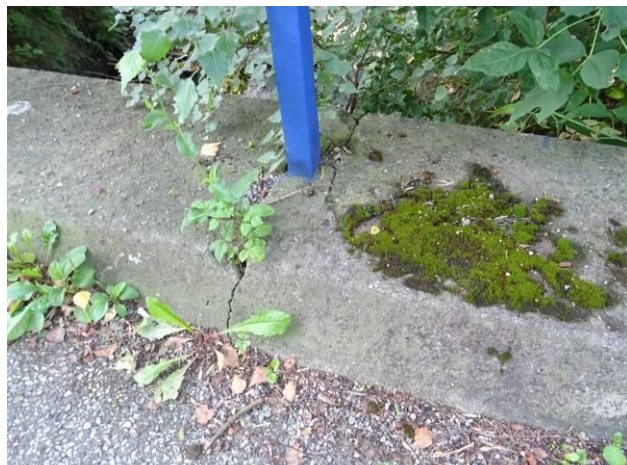
Pravá římsa – detail. Trhlina v římsě u sloupku zábradlí.
