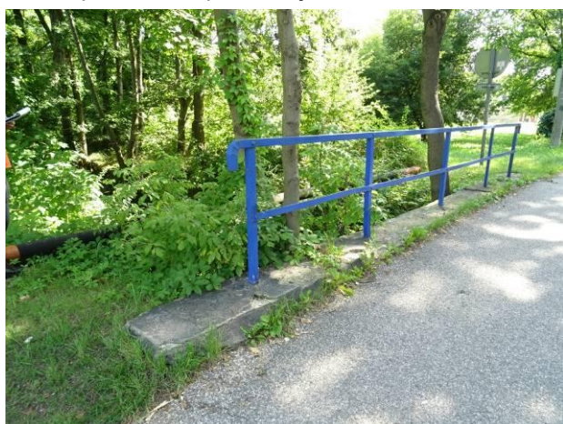
Levá římsa a zábradlí. Na straně opěře 2 je římsa cca v úrovni vozovky. Zábradlí je krátké.
