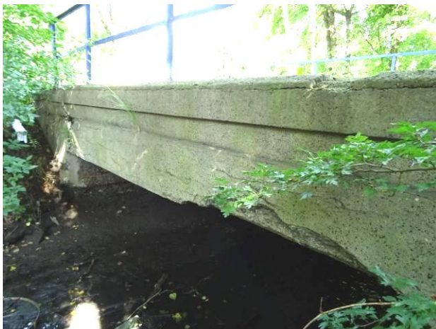
Pravý bok nosné konstrukce (vtok). Odlomená hrana nosné konstrukce.
