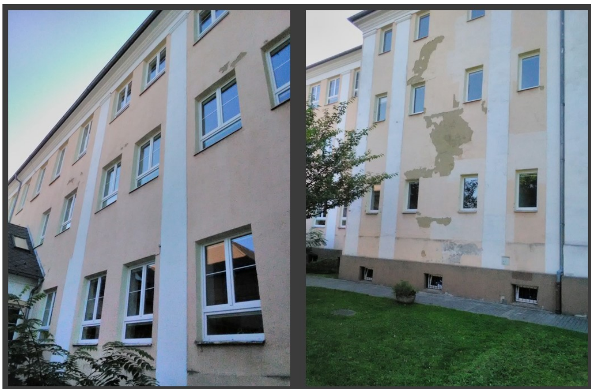
Nesoudržné části omítky v hlavních fasádních plochách
