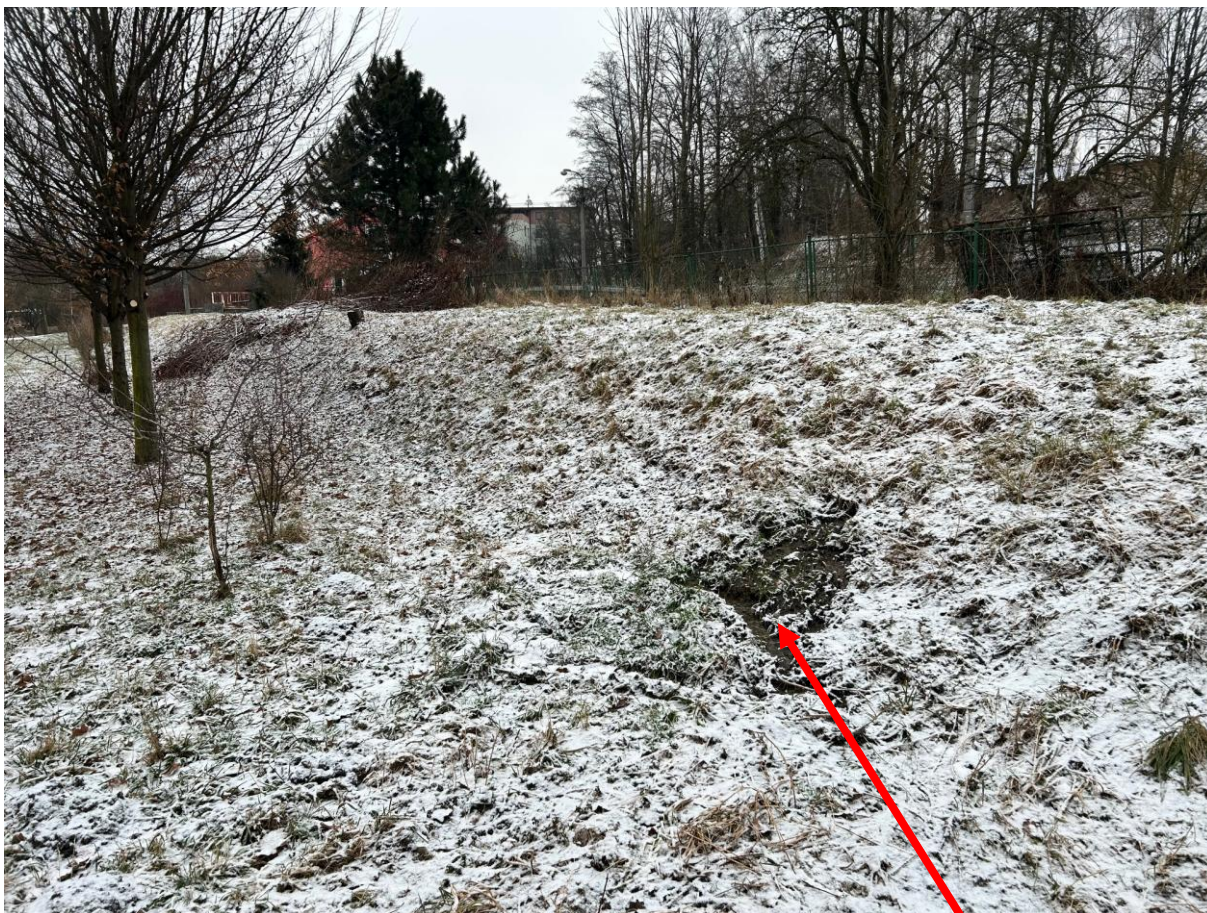
Obr. č. 5 Pohled na DVT Skřečošský potok řkm 1,119 - 1,199 – průsaký vody levobřežní zemní hrází z koryta toku
